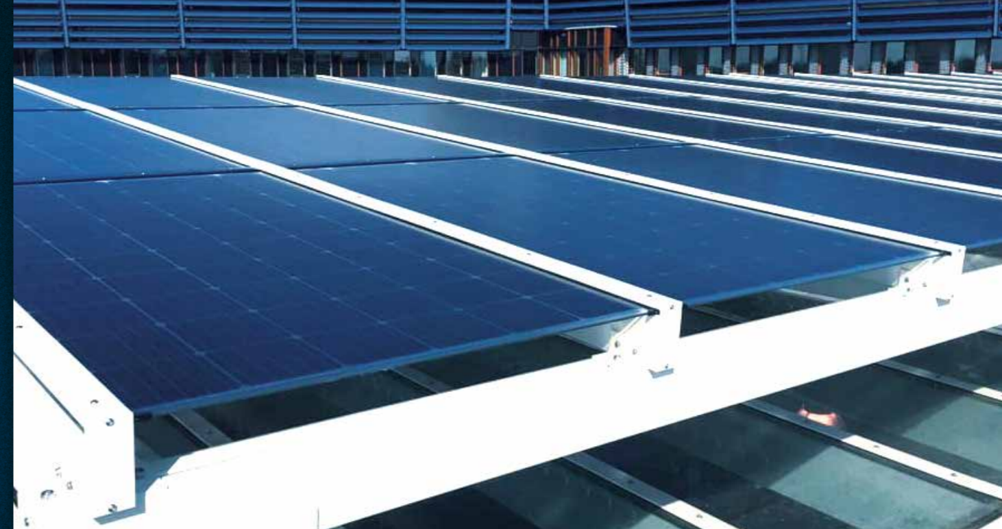
Zonnepanelen op het dak van locatie Deventer
